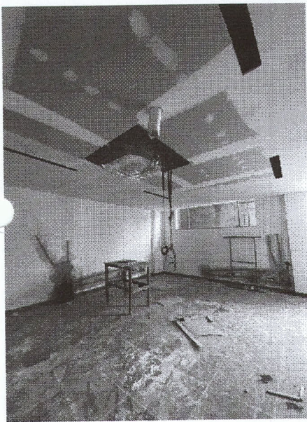
=> FORRO EM DRYWALL E SISTEMA DE AR CONDICIONADO - EQUIPAMENTO TIPO CASSETE
