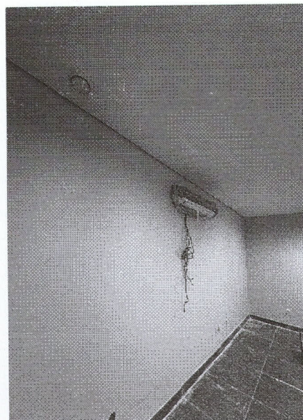
=> Evaporadora e difusor de ar - 1 Pavimento
