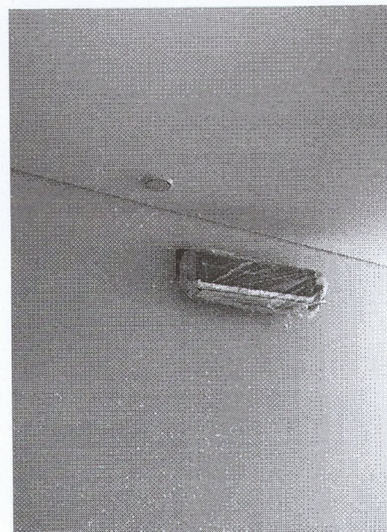
=> Evaporadora e Difusor de Ar - 1 Pavimento
